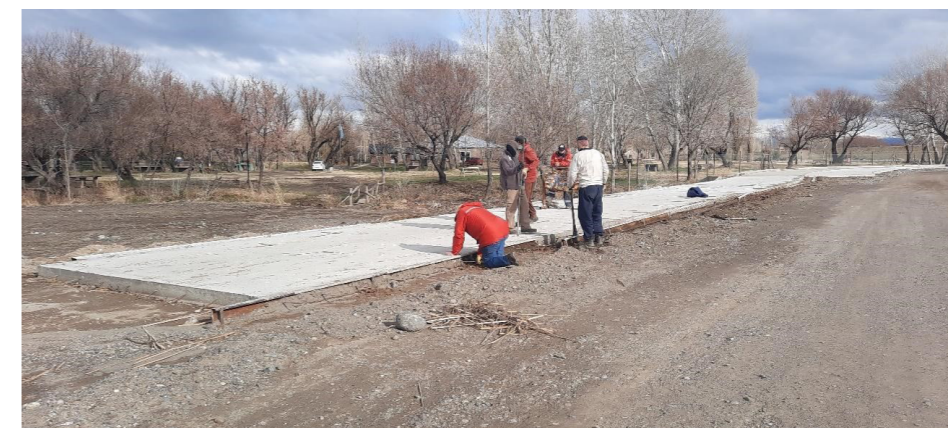
▲ Imagen 20. Avance de las obras de infraestructura vial peatonal de la Costanera. Fuente: ONU-Habitat, 2023.
